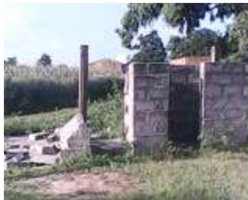
Latrines école élémentaire effondrées à Koussan
